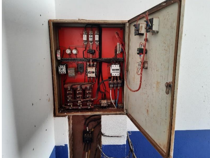
Figura 65: Acionamento do Poço Raposo Tavares.
