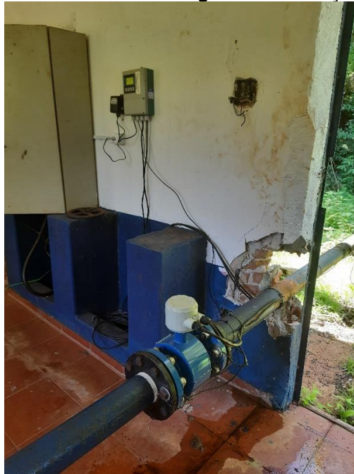
Figura 68: Macromedidor de Água Bruta – Poço Chácara.
