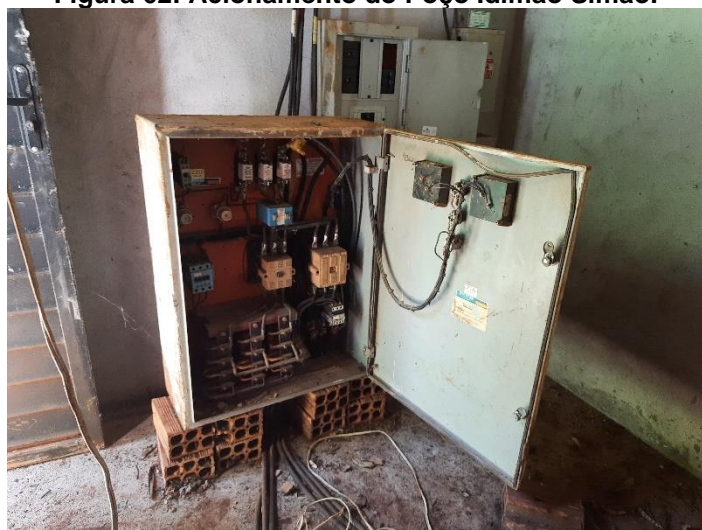
Figura 62: Acionamento do Poço Idimão Simão.
