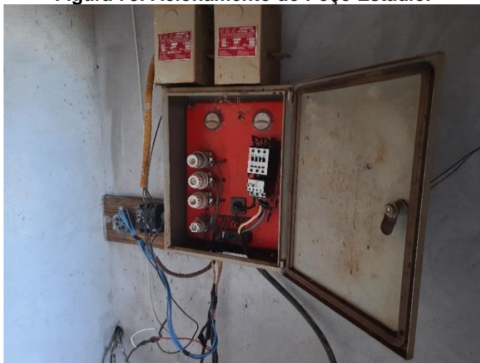
Figura 78: Acionamento do Poço Estádio.
