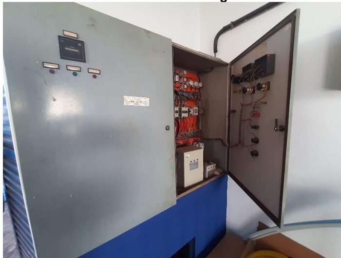
Figura 72: Acionamento da Elevatória de Água Tratada Para o Elevado.
