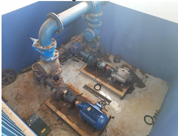
Figura 71: Elevatória de Água Tratada do Reservatório Elevado.
