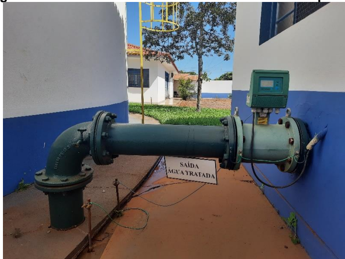
Figura 73: Macromedidor de Saída do Reservatório Apoiado.
