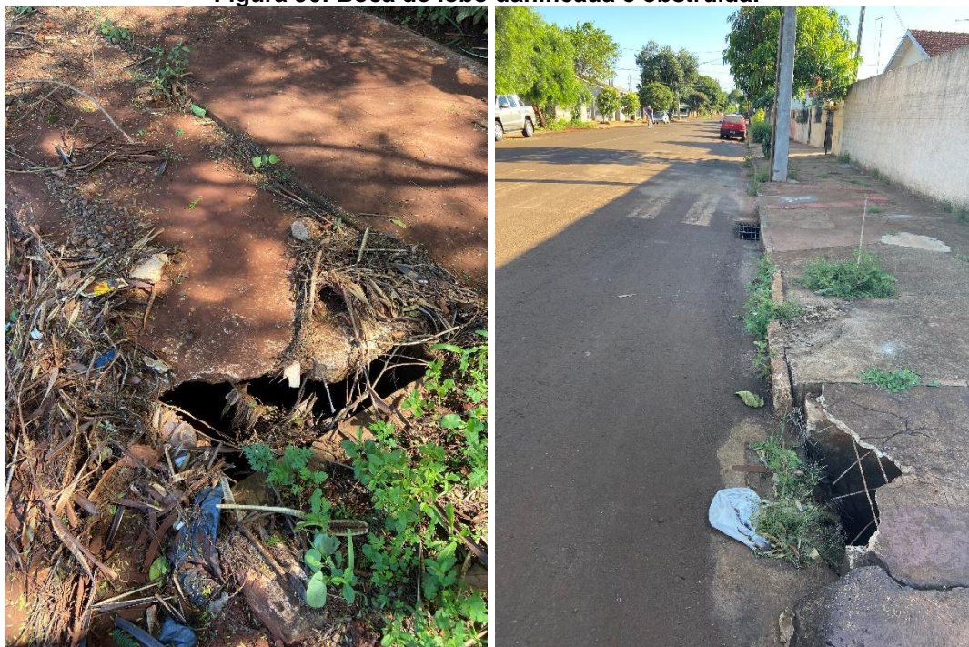
Figura 96: Boca de lobo danificada e obstruída.
