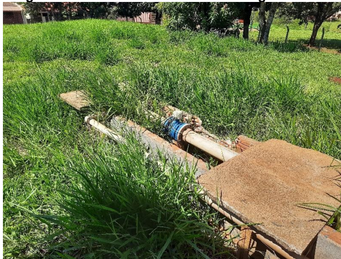
Figura 84: Macromedidor de Saída da Água Tratada.
