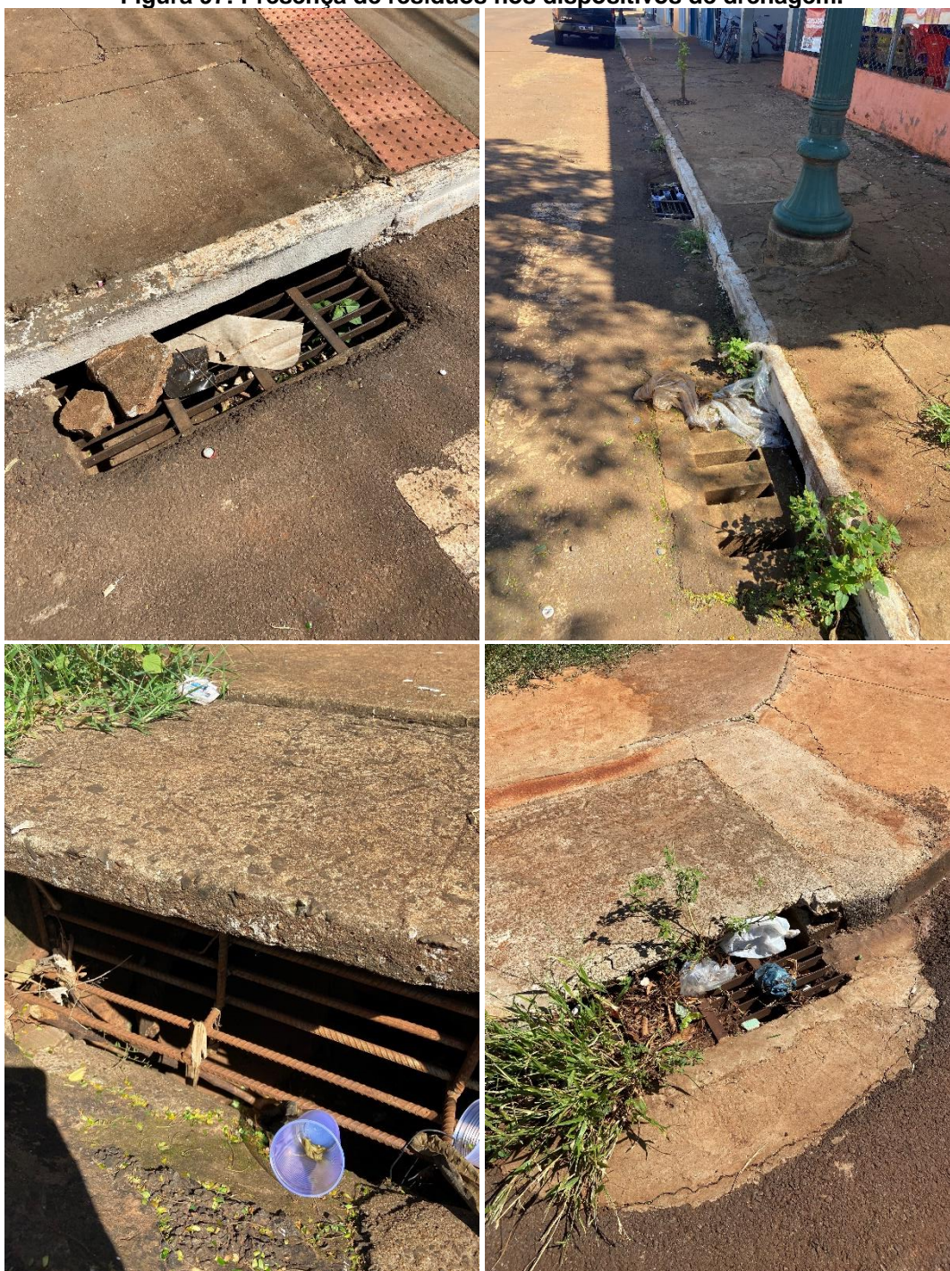
Figura 97: Presença de resíduos nos dispositivos de drenagem.
