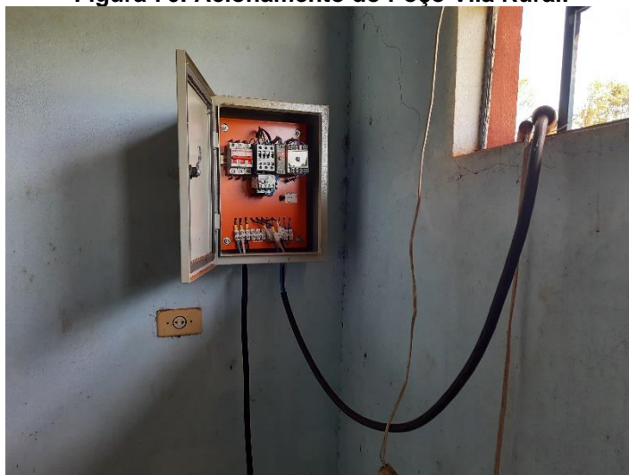
Figura 76: Acionamento do Poço Vila Rural.
