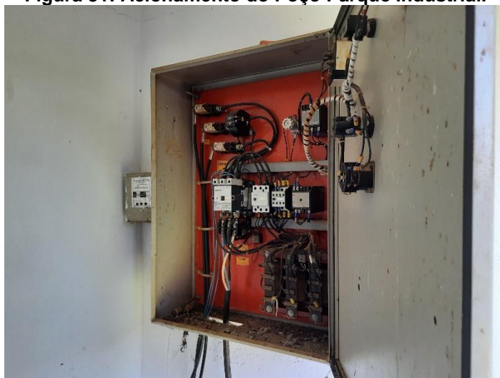
Figura 81: Acionamento do Poço Parque Industrial.
